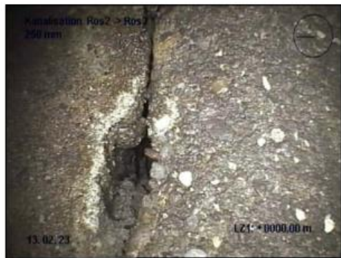
0.00 m Foto 1 Fehlende Scherbe / Wandungsteil an der Rohrverbindung 9 Uhr, Übergang zu Schac
